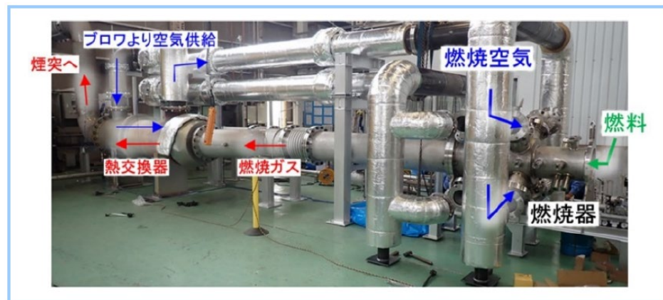
アンモニア燃焼試験装置
