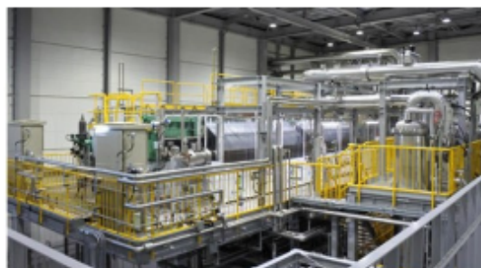
10MWの水電解装置
