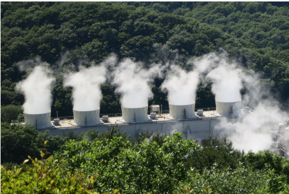
九州電力八丁原地熱発電所
