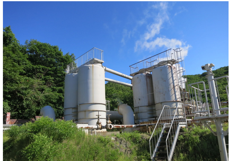
九州電力八丁原発電所
