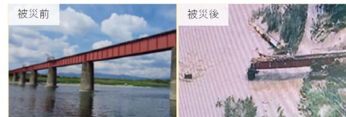
くま川鉄道 球磨川第4橋梁 の流出
