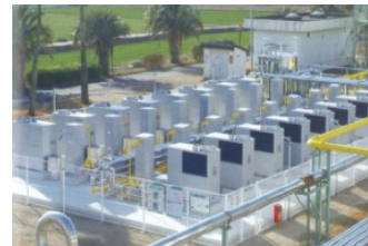
汚泥を活用したバイオガス発電
