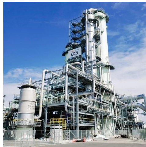
CO2回収実証プラント (稼働開始：2020年10月)
